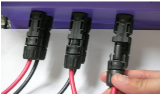
Fig 3.3.2.3 Collegamento di terminale FV +
