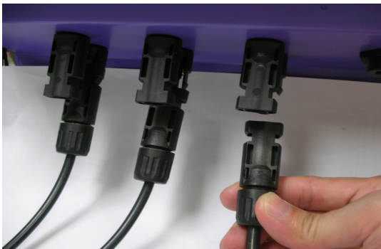
Fig 3.3.2.2 Collegamento di terminale FV -
